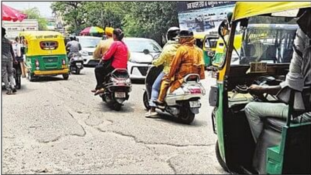
अस्पताल के सामने टूटी सड़क। अमर उजाला
